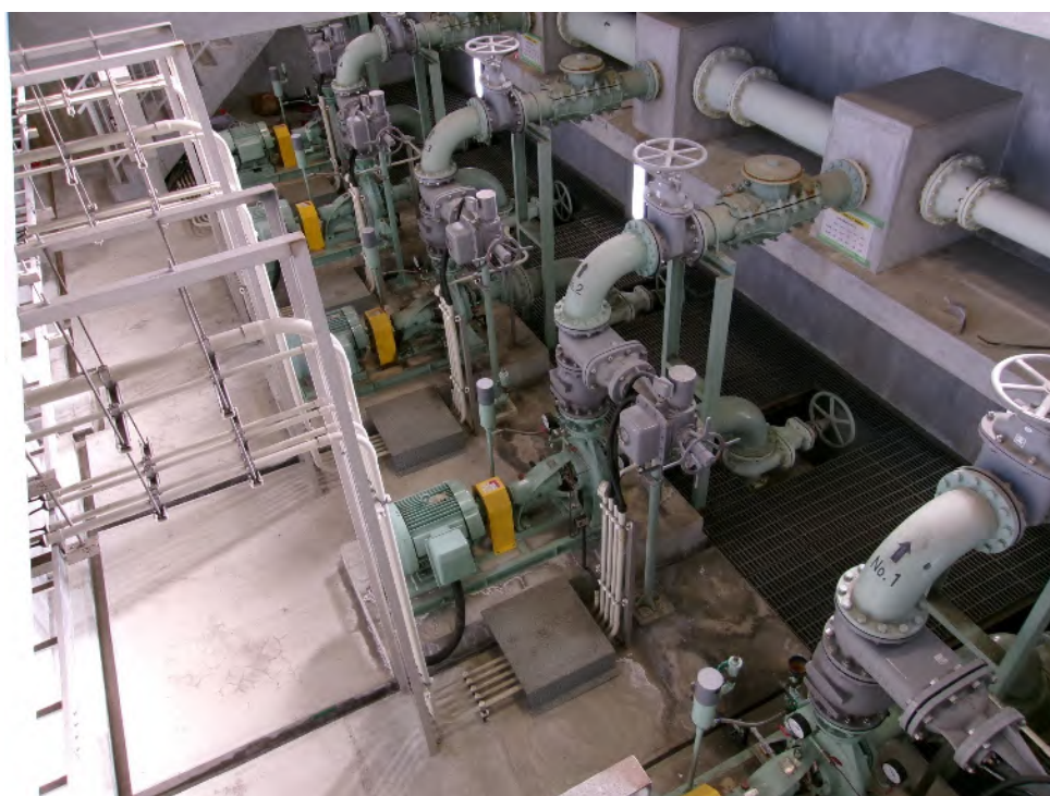
写真 3.2.1 大刀洗配水場 配水ポンプ
